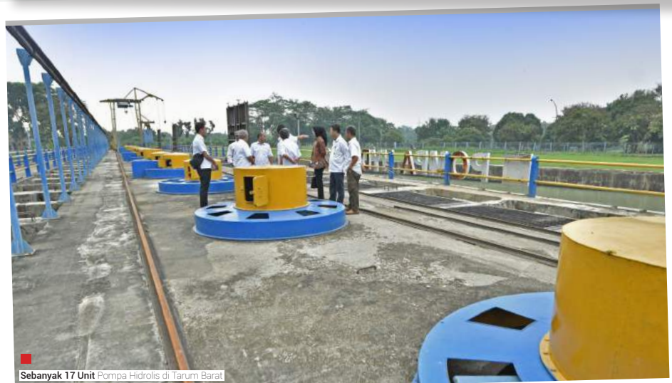
Sebanyak 17 Unit Pompa Hidrolis di Tarum Barat
