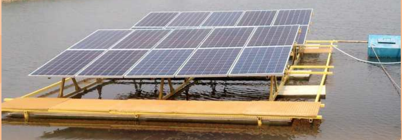
Peluncuran Pembangkit Listrik Tenaga Surya (PLTS) Floating PV di SPAM Curug
